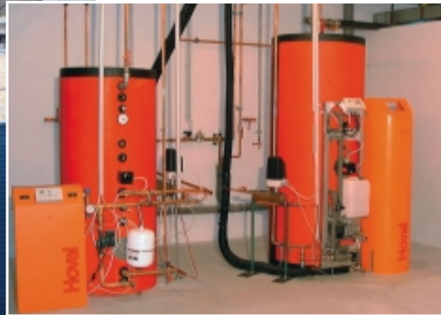
Bild 2: Aufstellung der Solarspeicher im Labor der FH.
